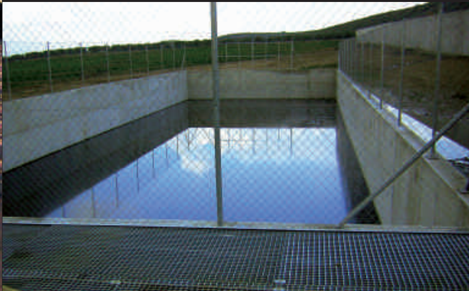
Ilustración 13.- Balsa de lixiviados
